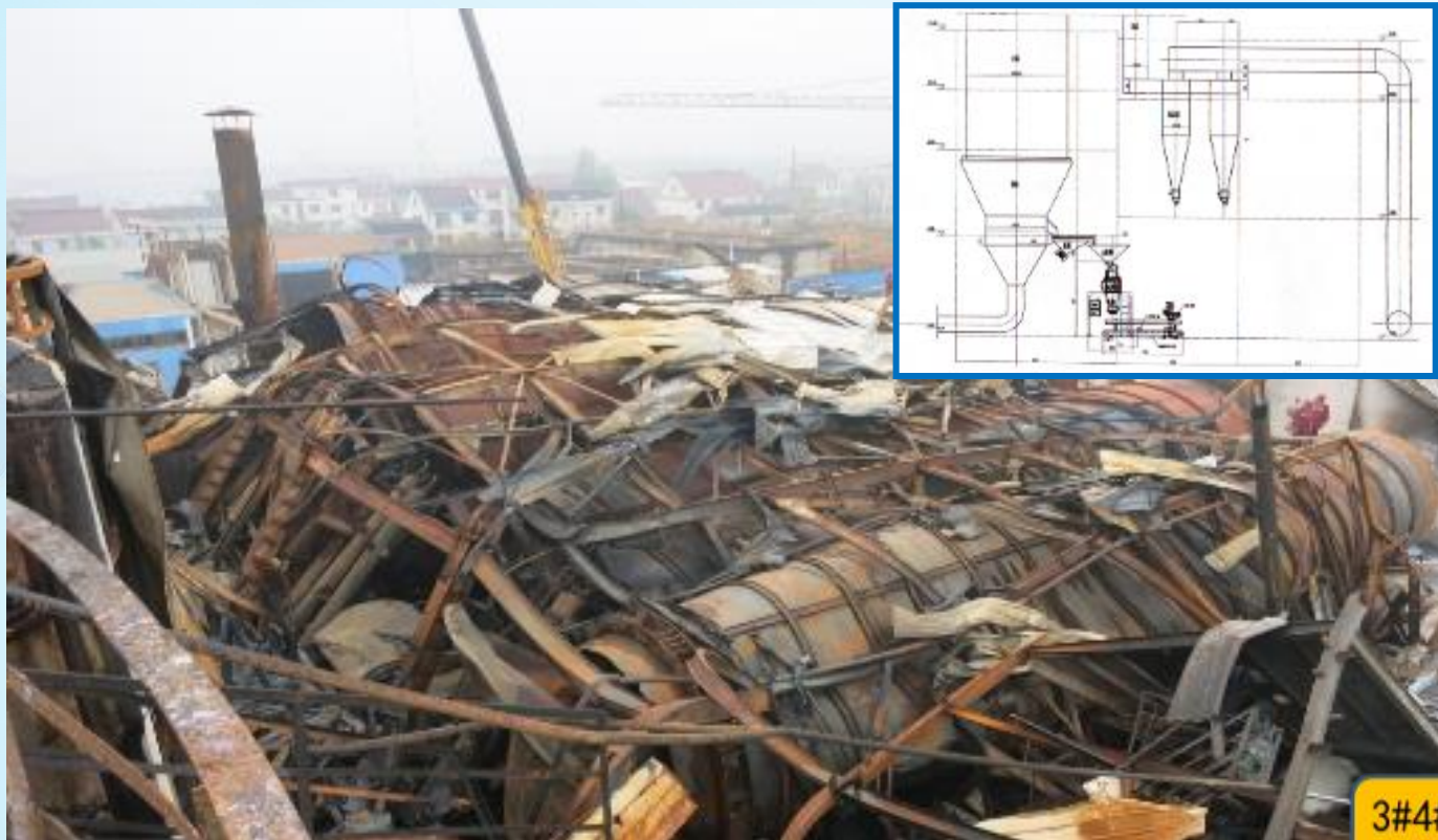
造粒包装车间整体倒塌
