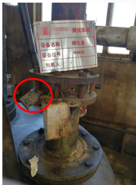
爆破片铭牌腐蚀污损， 相关参数模糊不清
